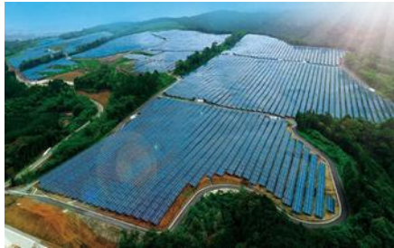
S-13 CS益城町発電所 47.7MW
