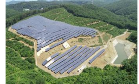
S-20 CS丸森町発電所 2.2MW
