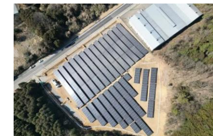
S-34 CSさくら市喜連川発電所 1.2MW
