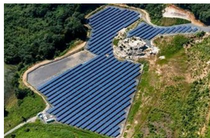
S-07 CS笠間市第二発電所 2.1MW
