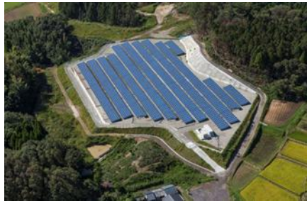
S-02 CS伊佐市発電所 0.9MW
