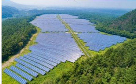
S-17 CS大山町発電所(A) 同発電所(B) 27.3MW
