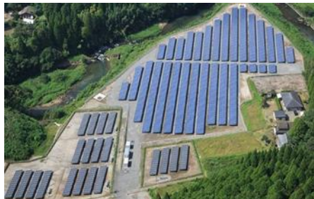
S-01 CS志布志市発電所 1.2MW
