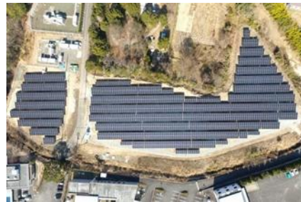
S-31 CS山口市発電所 1.1MW
