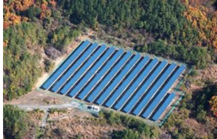
S-14 CS郡山市発電所 0.6MW
