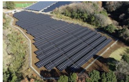
S-35 CSつくば市高見原発電所 1.1MW
