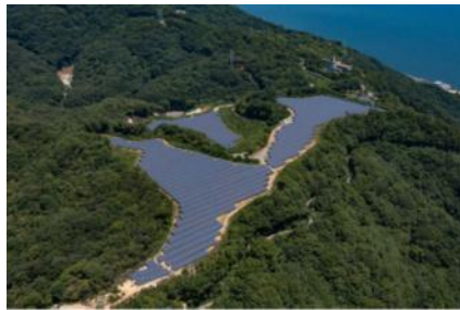
S-26 CS福山市発電所 3.3MW
