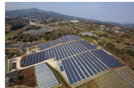
S-08 CS日出町発電所 2.6MW
