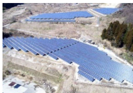
S-11 富山高岡3号太陽光発電所
