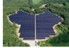
S-14 石川能登合鹿太陽光発電所
