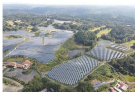
S-42 福島石川太陽光発電所
