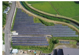
S-07 三重紀宝太陽光発電所
