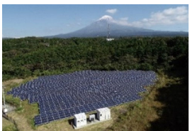
S-23 静岡大岩太陽光発電所
