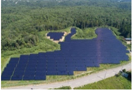
S-13 石川能登明野太陽光発電所
