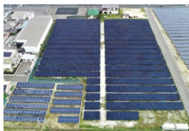
S-02 広島生口島太陽光発電所
