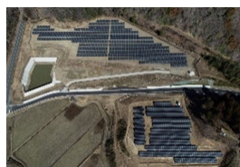
S-28 茨城常陸大宮太陽光発電所
