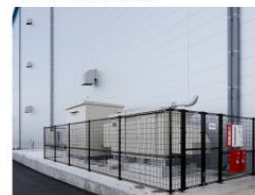
非常用発電機
