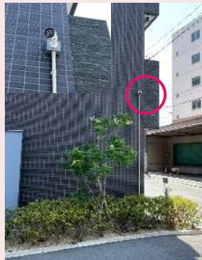
監視カメラ設置 (アルティザ淡路駅東他)
