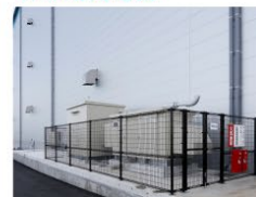
非常用発電機
