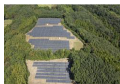
S-59 群馬高崎中室田太陽光発電所
