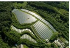
S-37 熊本山江村太陽光発電所
