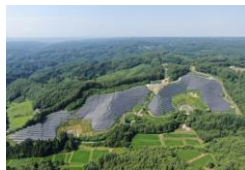
S-46 青森南部町太陽光発電所
