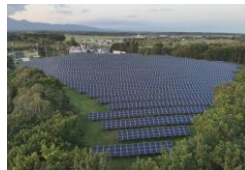
S-56 北海道中標津北中太陽光発電所
