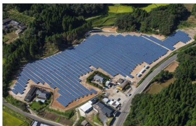
S-06 CS伊佐市第三発電所 2.2MW
