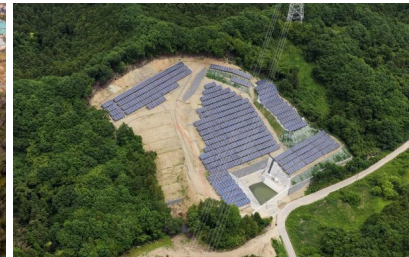
S-19 CS美里町発電所 1.1MW
