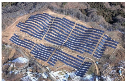
S-11 CS皆野町発電所 2.4MW
