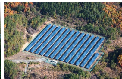
S-14 CS郡山市発電所 0.6MW
