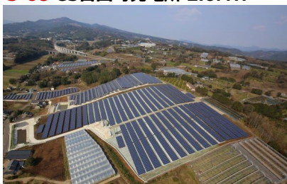
S-08 CS日出町発電所 2.6MW
